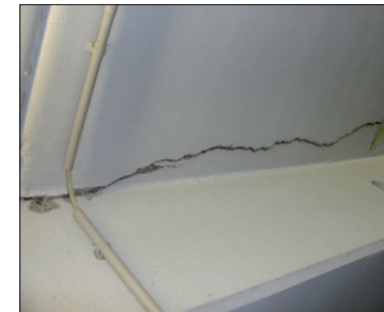
Fissuration en dehors des points d'appui.
