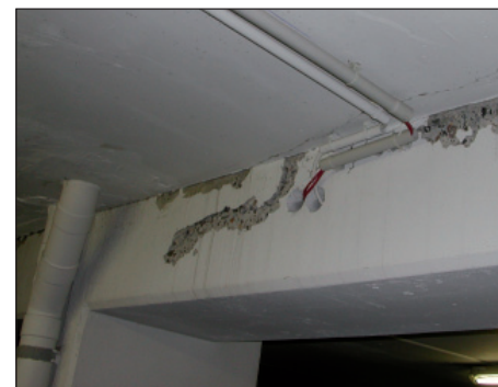
Fissuration des planchers en limite d'appui.
