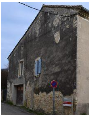
Mur pierre enduit ciment craquelé
